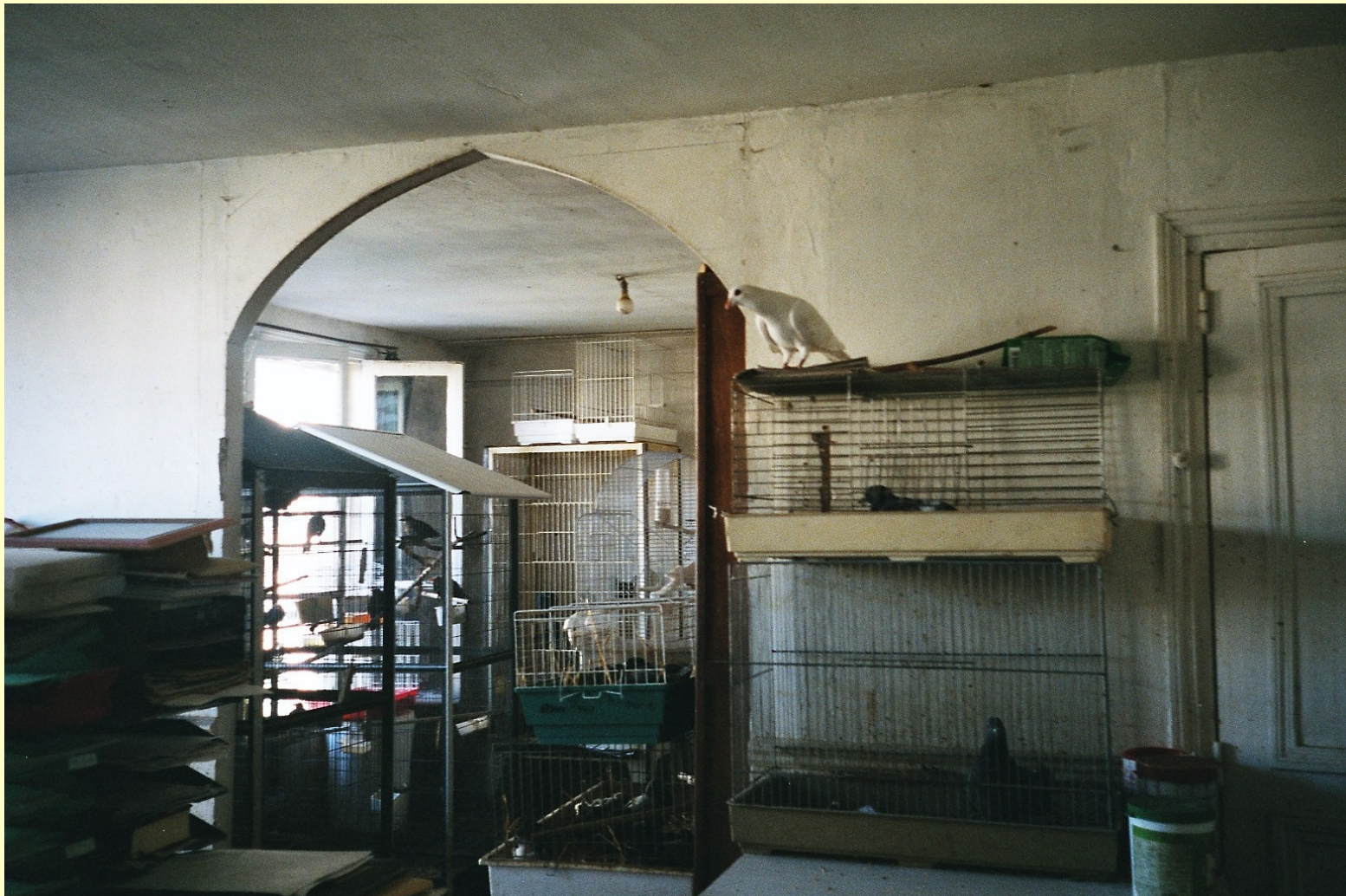
Premier étage avec les volières des vieux merles – photo du 26/09/2003
