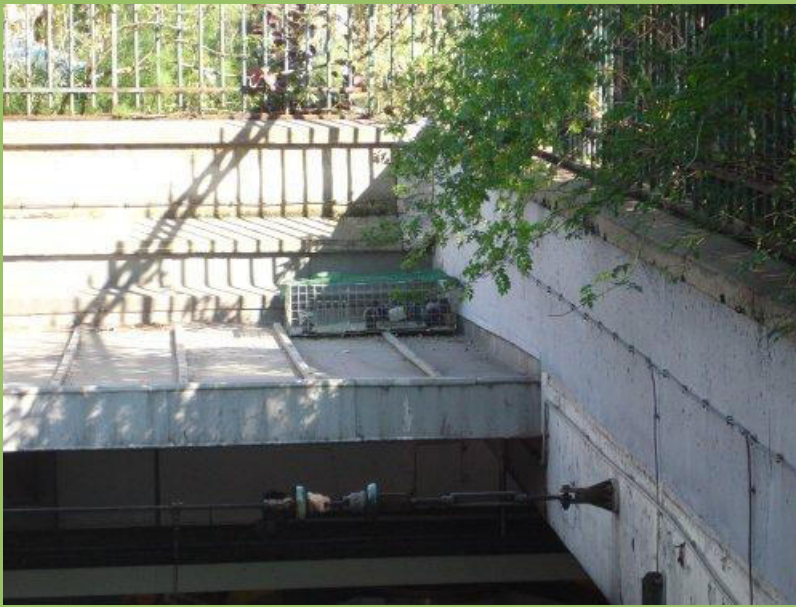
Place Denfert-Rochereau à Paris près des catacombes cage posée sur le toit d'un quai de métro
